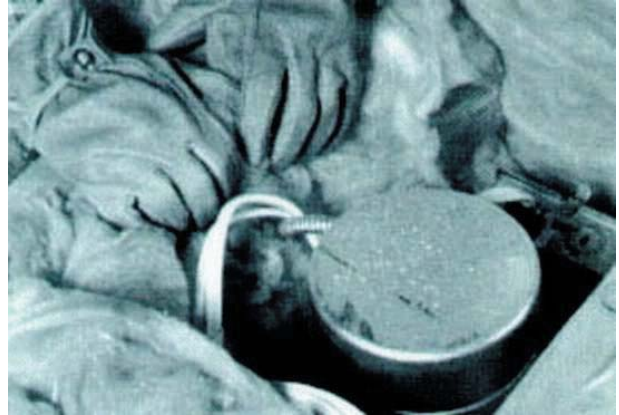
Figura 14 - 21: Se observa el cuidado que se debe tener de no atracar el aislante al foco empotrado en el cielo.
