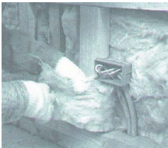
Figura 14 - 16: Material aislante en sectores de cajas y cañerías eléctricas.
