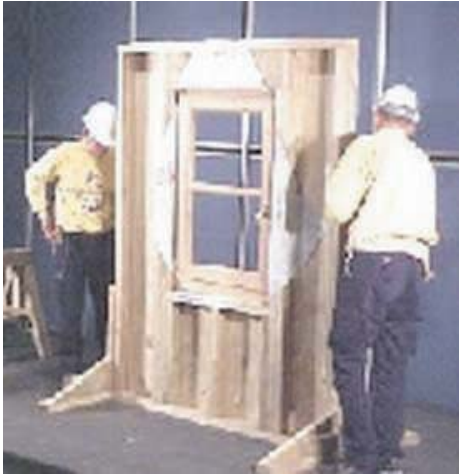
Figura 14 - 34: Colocación de la barrera de humedad en el rasgo de ventana desde el paramento exterior hacia el interior.
