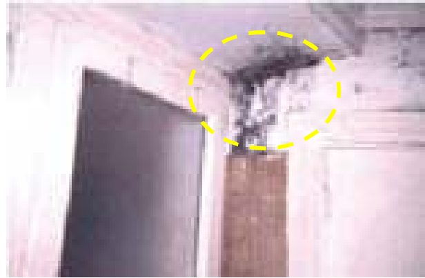
Figura 13 - 13: En un rincón de la habitación que colinda con un pasillo orientado hacia el lado sur de la vivienda, se observan las consecuencias de la humedad por condensación.
